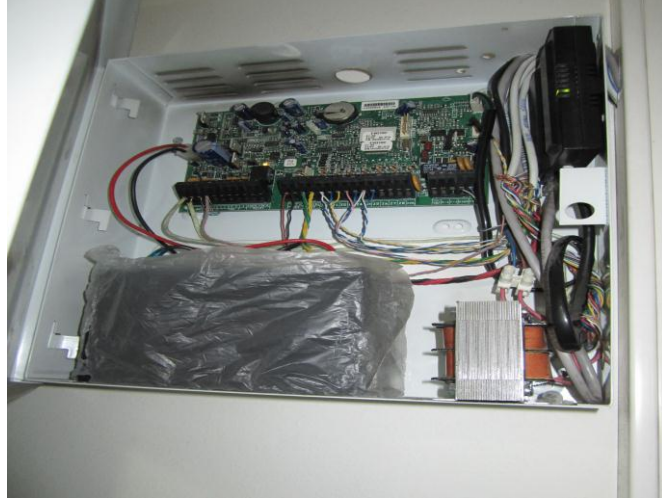
Resim 2.3: Kutu içine montajlı alarm paneli
